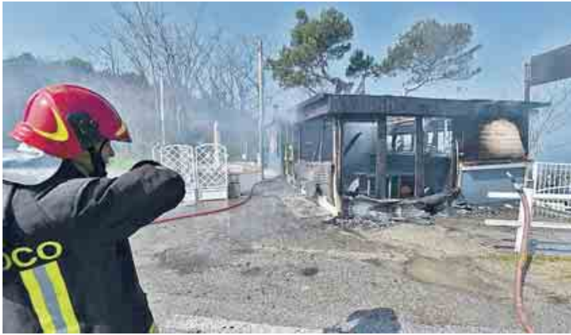
Anche ieri i vigili del fuoco sono tornati a «Il Sorpasso» per un sopralluogo (Foto TONI)
